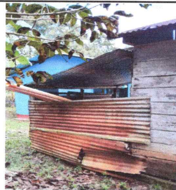
Foto 2: ESTA FOTOGRAFIA MUESTRA OTRO ANGULO DE LA COCINA EN DETERIORO DEL ESTABLECIMIENTO.
