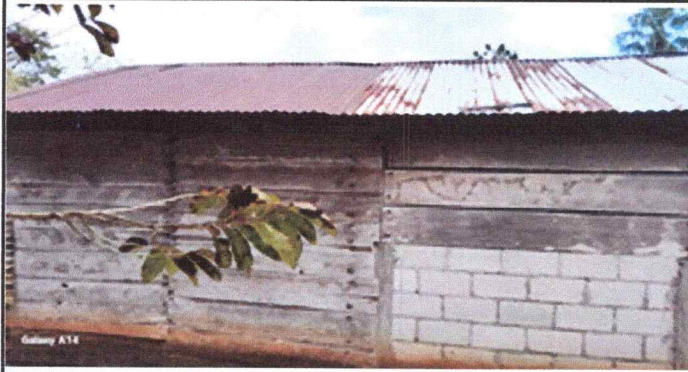
Foto1: EN ESTA FOTOGRAFIA SE OBSERVA EL DETERIORO DEL TECHO DE LA COCINA DEL ESTABLECIMIENTO.
