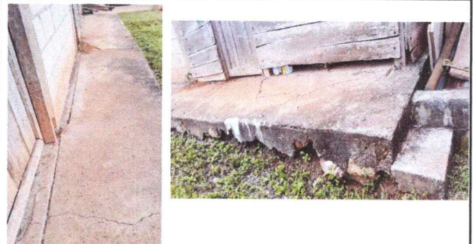
Foto 4: FOTOGRAFIAS QUE MUESTRAN EL ESTADO ACTUAL DEL PISO, SE ENCUENTRA QUEBRADO Y HAY PARTES FALSAS QUE SE ESTAN QUEBRANDO
