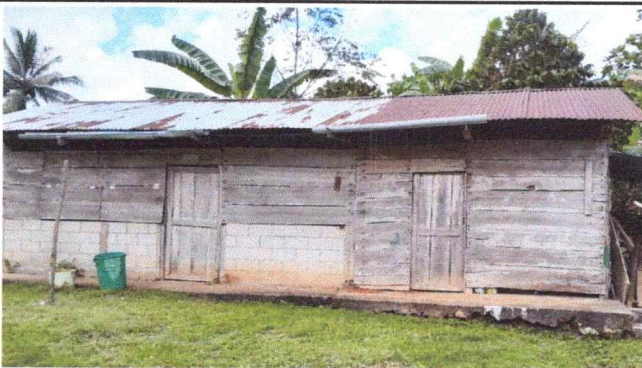
Foto 3: FOTOGRAFIA QUE MUESTRA EL ESTADO DE LAS PUERTAS ACTUALES Y QUE SE NECESITAN CAMBIAR EN LA COCINA.
